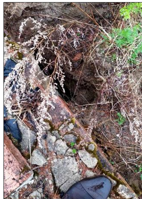
Нарушение герметизации объекта
