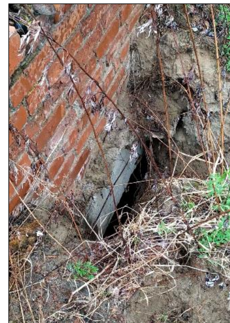
Нарушение герметизации объекта
